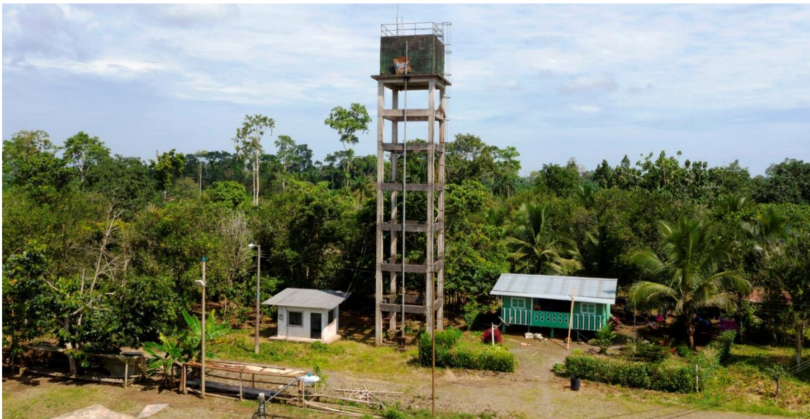
Fotografía N° 75. Tanque elevado en la comunidad 10 de Agosto
