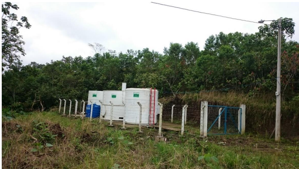
Foto 28: Planta de tratamiento de aguas residuales fuera de funcionamiento
