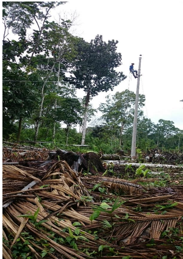
Foto 27: Servicio de energía eléctrica
